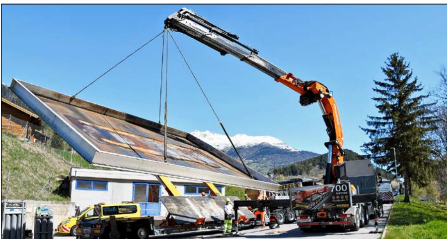
Emin Fejzullahi soulève l'imposant bac de rétention métallique avec sa grue et s'apprête à le déposer sur les supports inclinables de la remorque tractée par le camion de Gabriel Regamey.
